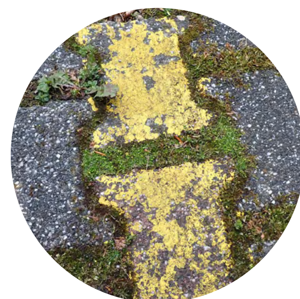
VÉGÉTATION DES FISSURES
